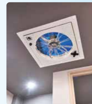
照明・換気扇
